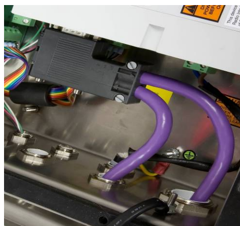
Figura 2-70: Roteamento do cabo PROFIBUS para gabinete de caixa de junção original
