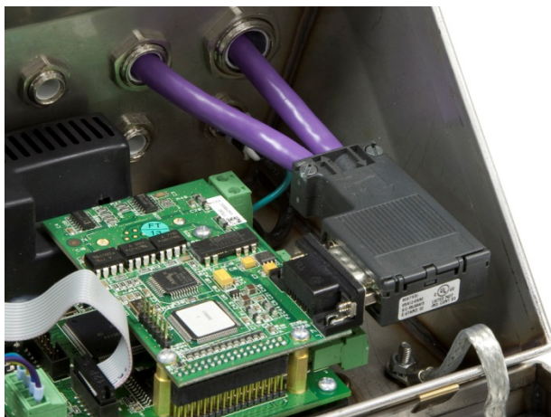
Figura 2-69: Instradamento del cavo PROFIBUS con armadietto per ambienti difficili
