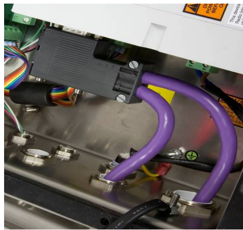
Figura 3-70: Colocación del cable PROFIBUS en el gabinete para caja de conexiones, versión original
