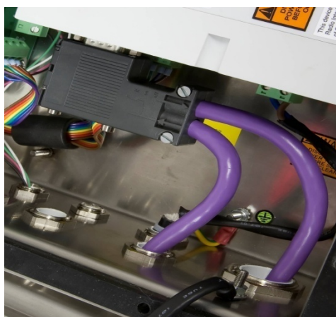
Figure 2-70 : Acheminement des câbles PROFIBUS pour boîtier J-Box, version originale
